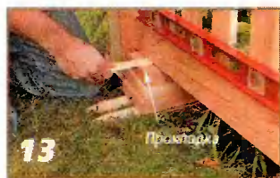
13 Правильность положения конструкции обеспечивают прокладками, которые временно подкладывают под нижнюю обвязку боковой панели.
